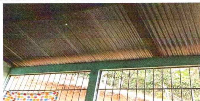
Foto 5: LAMIMAS CON GOTERAS
